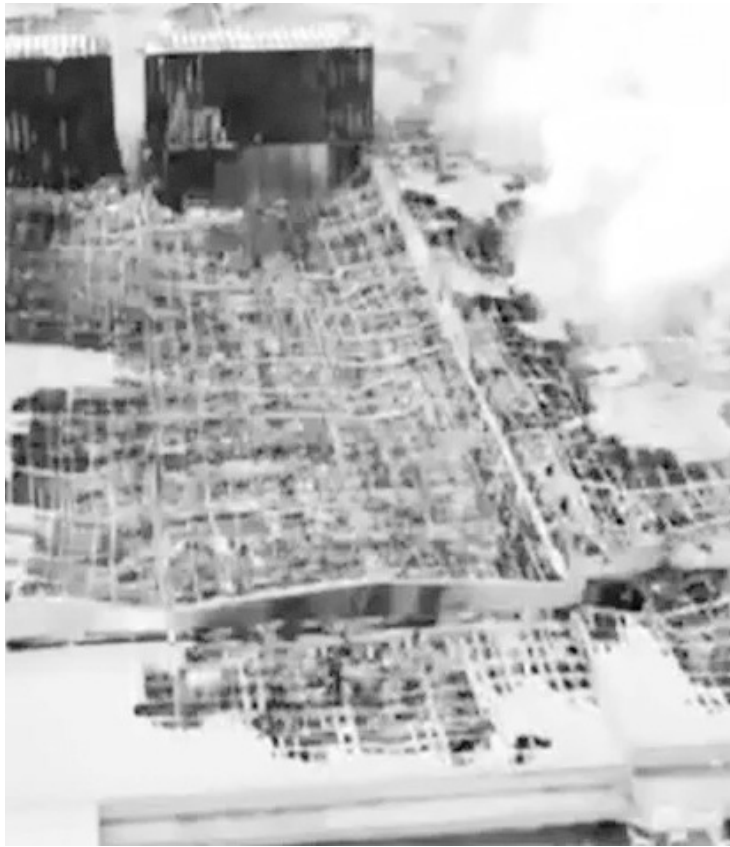
Imagens aéreas mostram estrutura danificada em frigorífico
