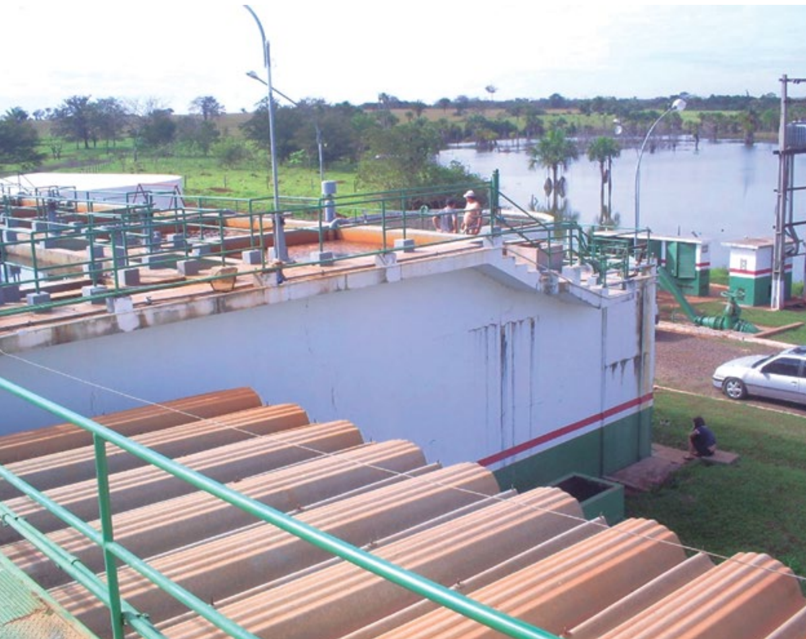
Grupo gerador de energia e equipamentos reservas são as principais demandas da ETA
