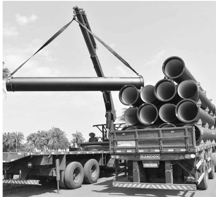
Obra de captação e adução de água do Rio Sepotuba
