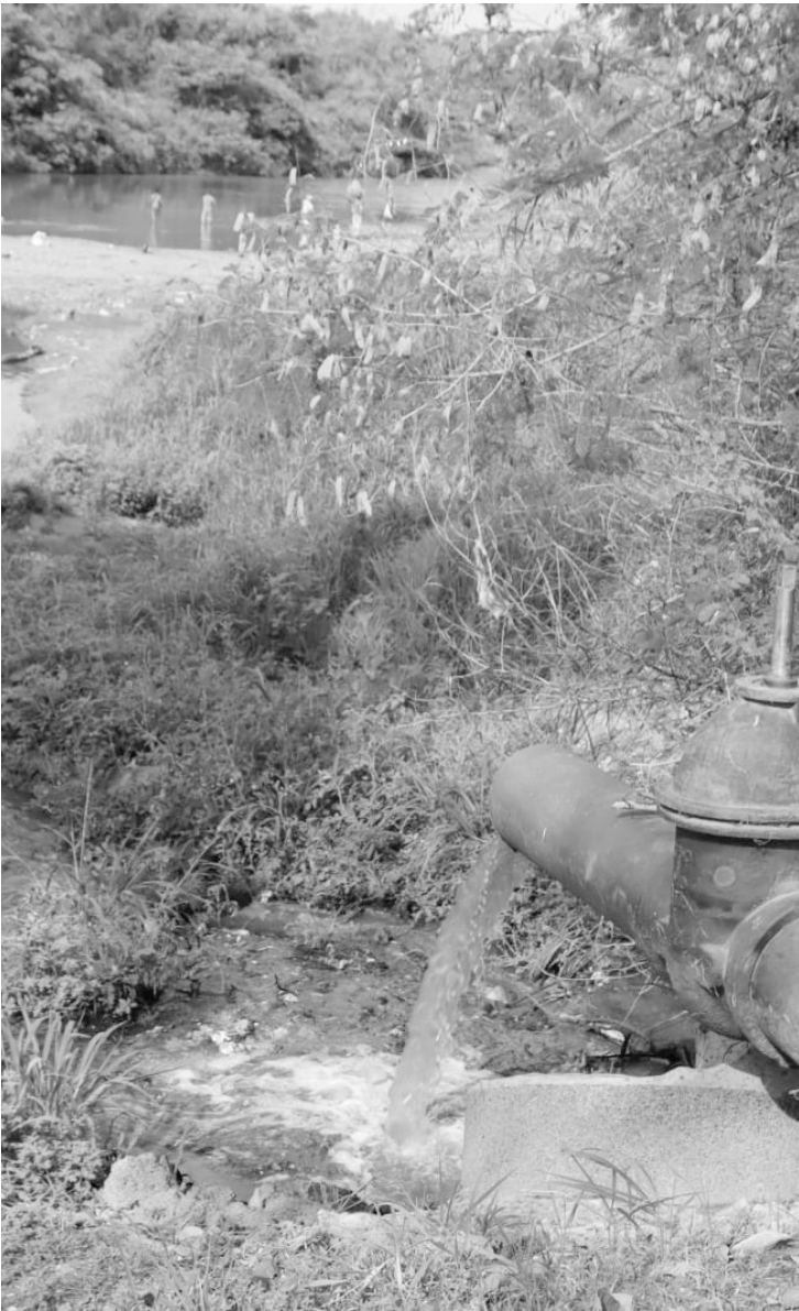
Esgoto jogado diretamente no Rio Paraguai
