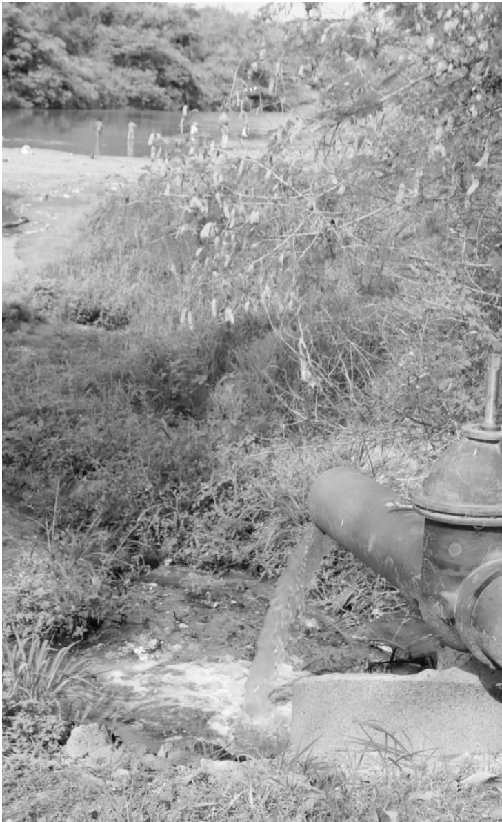
Esgoto jogado diretamente no Rio Paraguai
