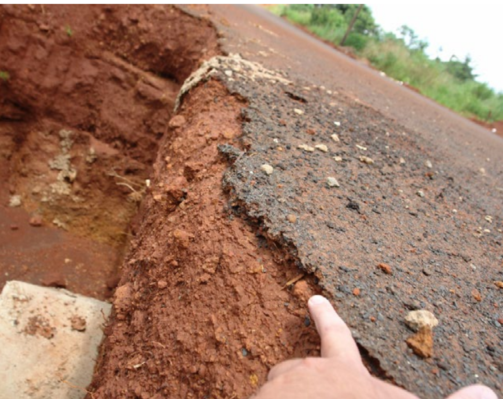
A qualidade das obras de pavimentação da Avenida Brasil está sendo questionada
