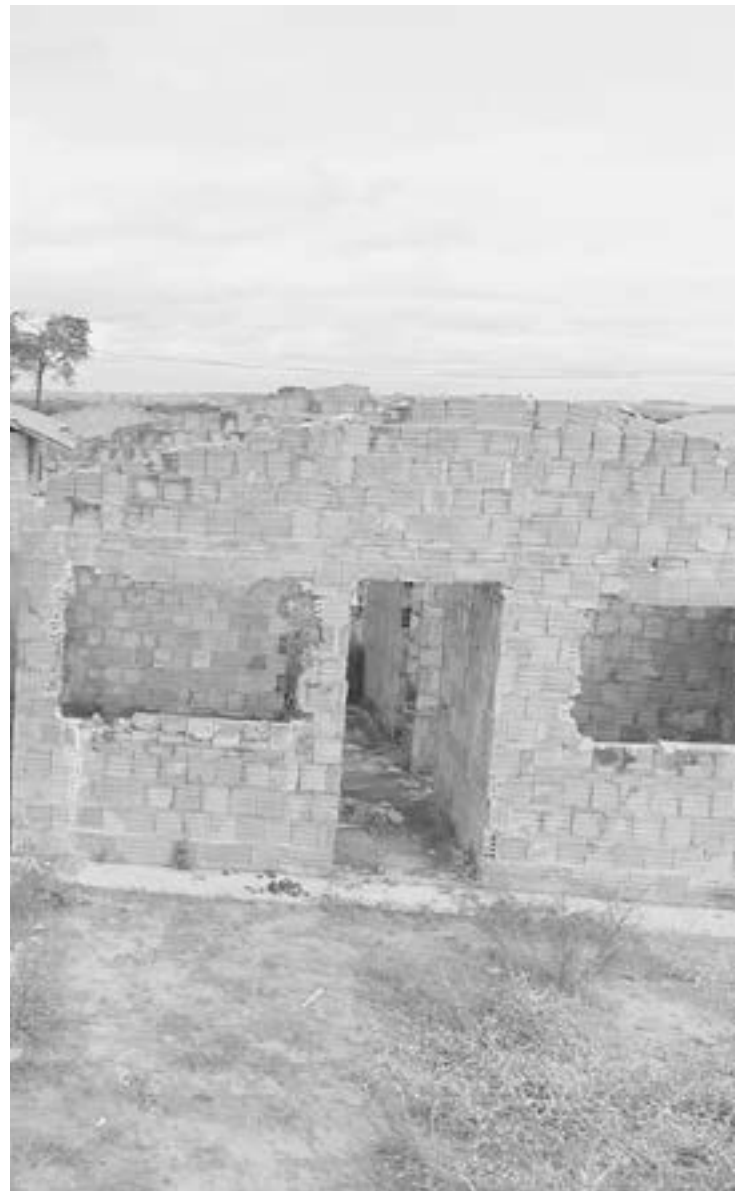
Obras estão paralisadas
