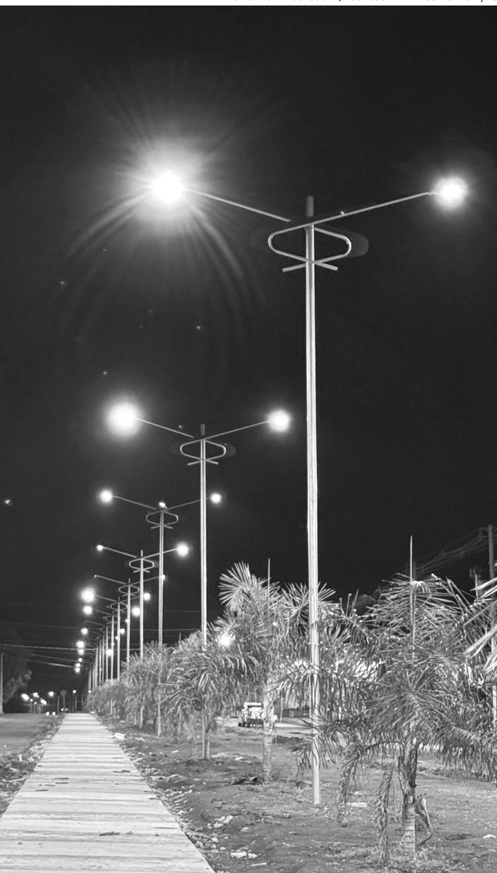
ILUMINAÇÃO LED NO CANTEIRO CENTRAL DA VIA
