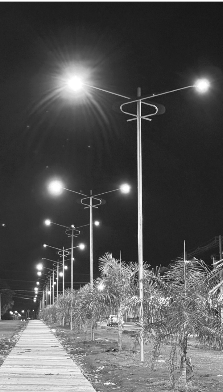
ILUMINAÇÃO LED NO CANTEIRO CENTRAL DA VIA
