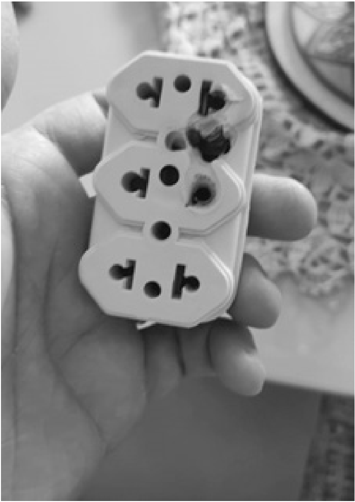
SOBRECARGA EM EQUIPAMENTOS ELÉTRICOS
