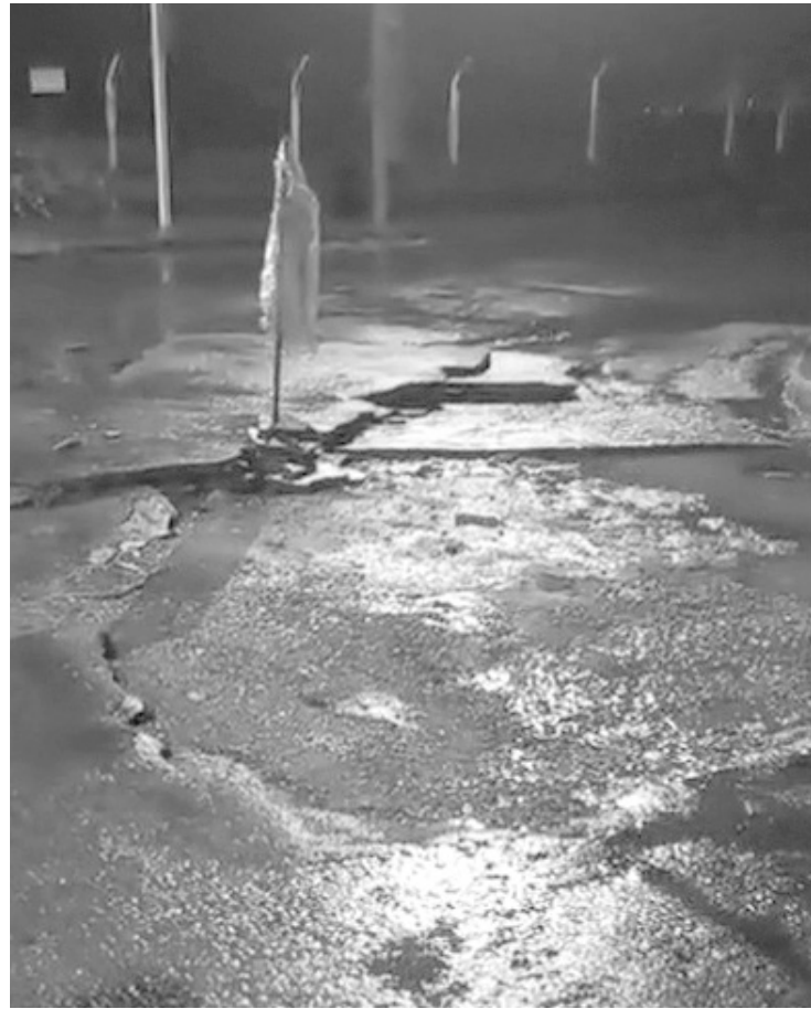
INFRAESTRUTURA MONITORA PONTOS CRÍTICOS
