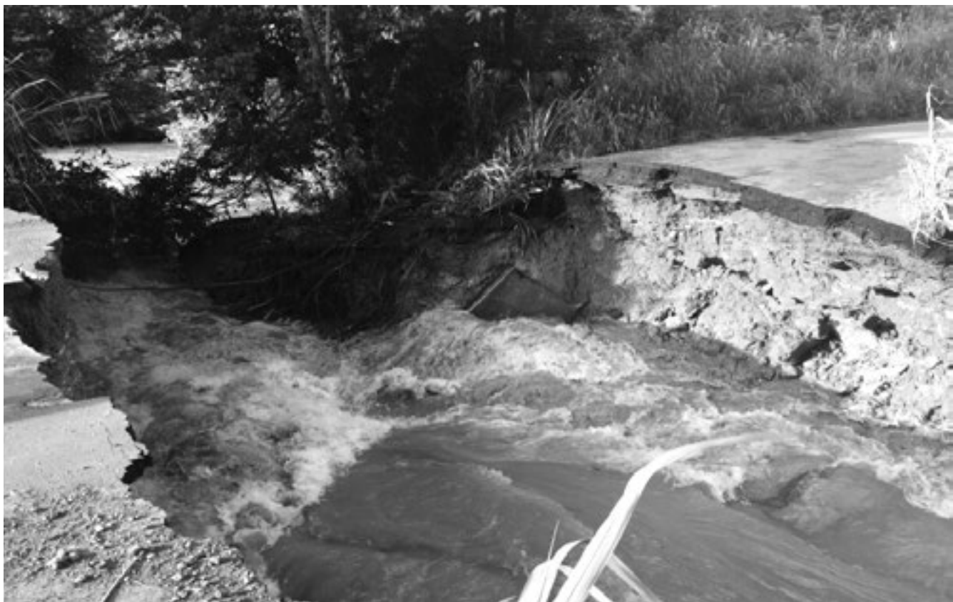
No local onde foi aberta uma cratera havia um bueiro por onde passava a água de um córrego
