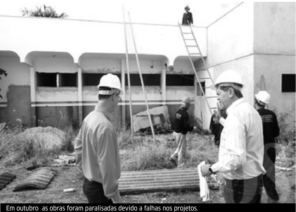
Em outubro as obras foram paralisadas devido a falhas nos projetos.
