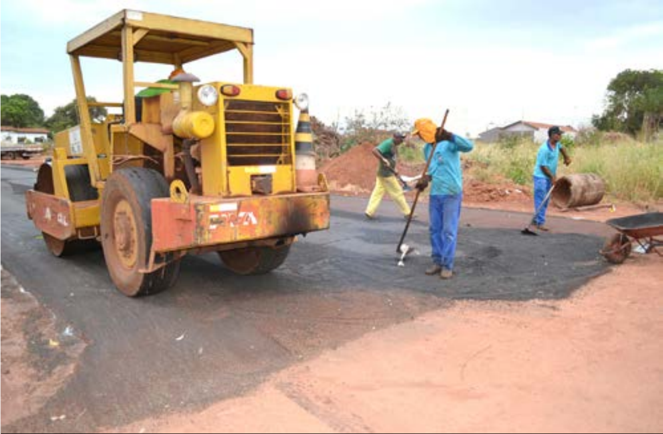
A pavimentação asfáltica é uma das reivindicações dos moradores da região
