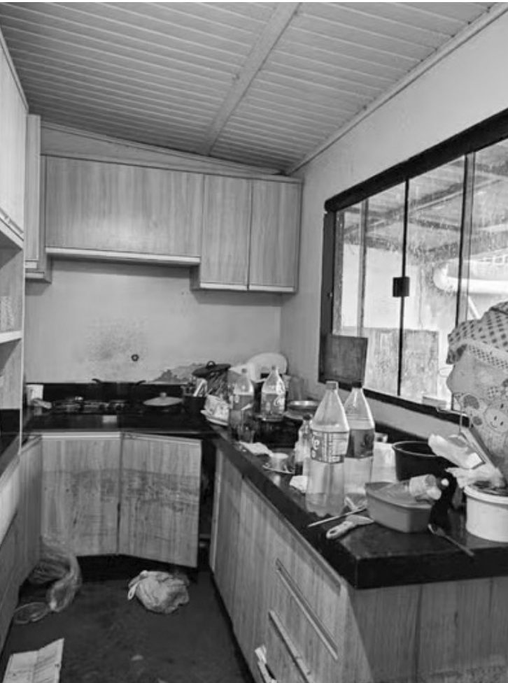
REGISTRO MOSTRA A SITUAÇÃO DO IMÓVEL APÓS O ALAGAMENTO
