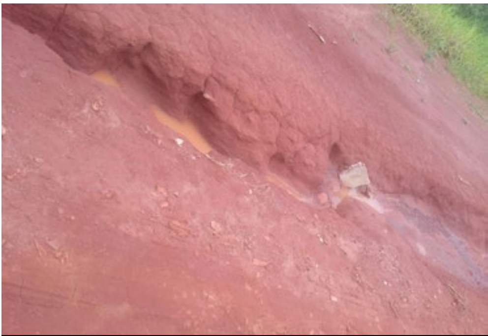
Buracos na Rua 38 A atrapalham moradores
