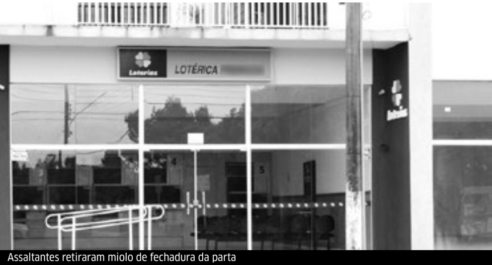
Assaltantes retiraram miolo de fechadura da porta
