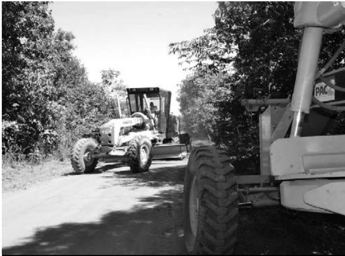
Nova Olímpia possui mais de 300 km de estradas de chão que precisam de reparos constantemente
