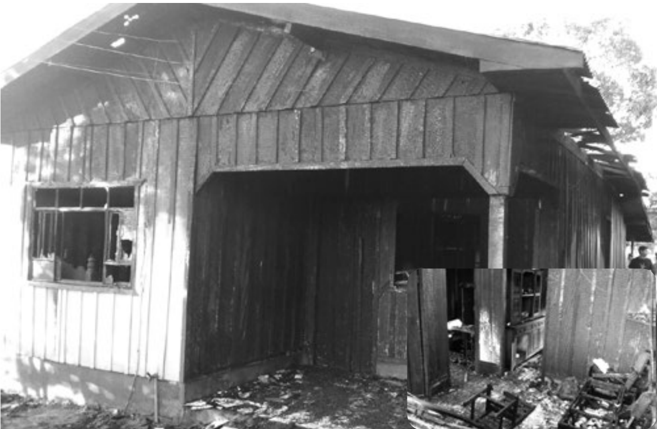
Incêndio deu perda total na residência
