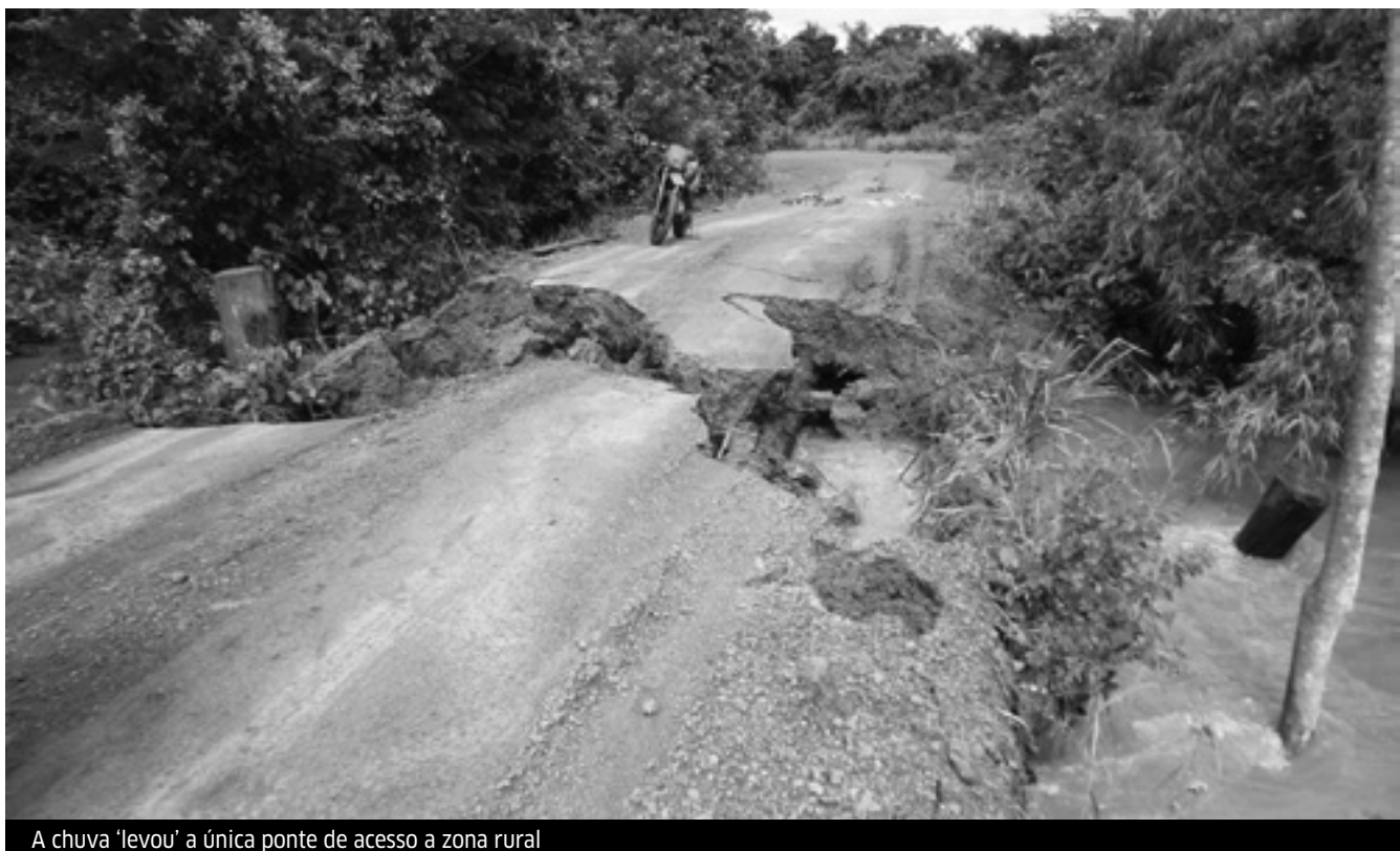
A chuva ‘levou’ a única ponte de acesso a zona rural
