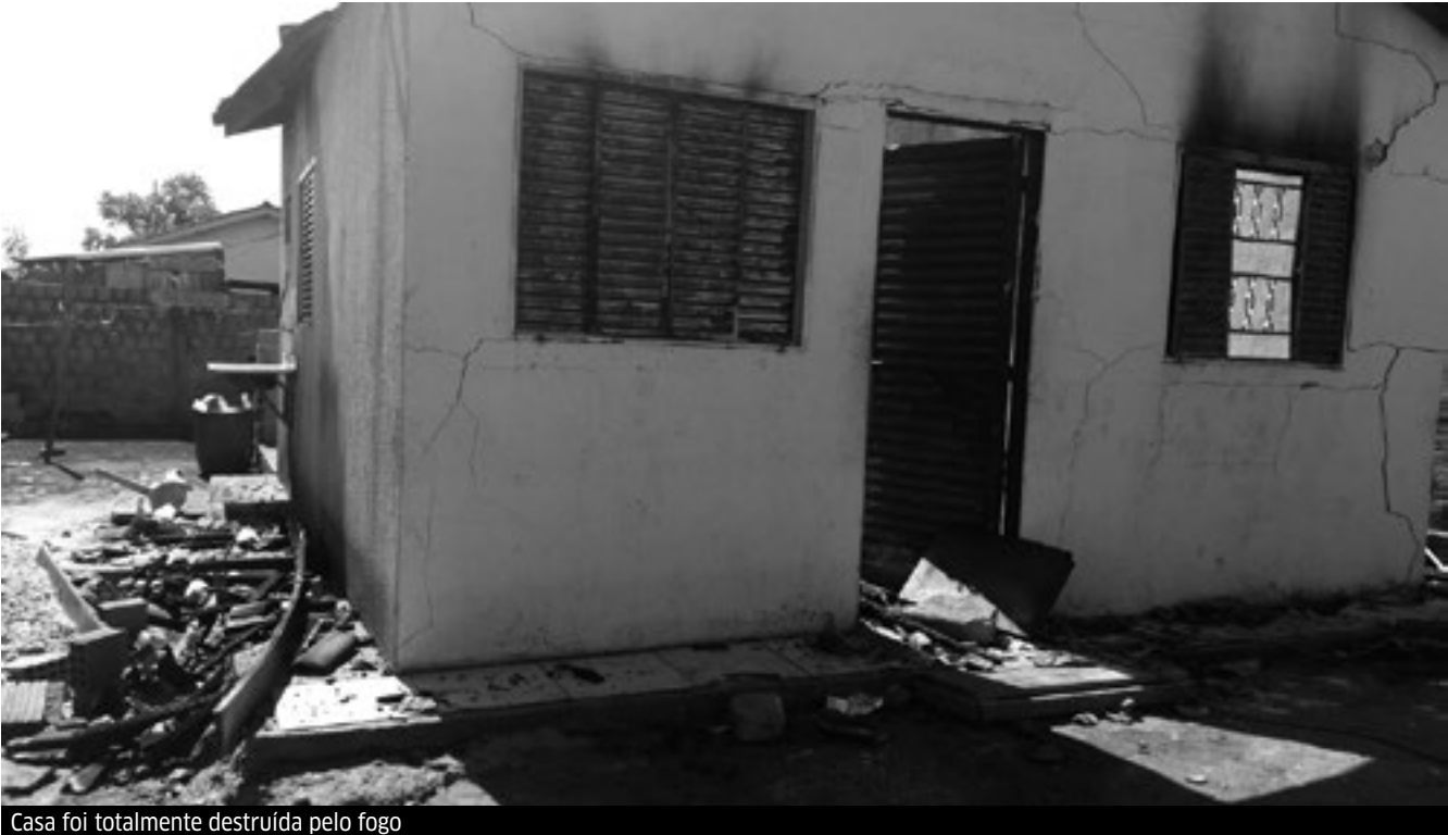
Casa foi totalmente destruída pelo fogo
