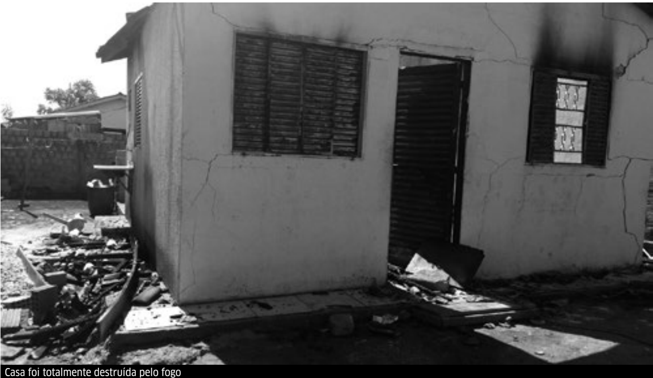
Casa foi totalmente destruída pelo fogo
