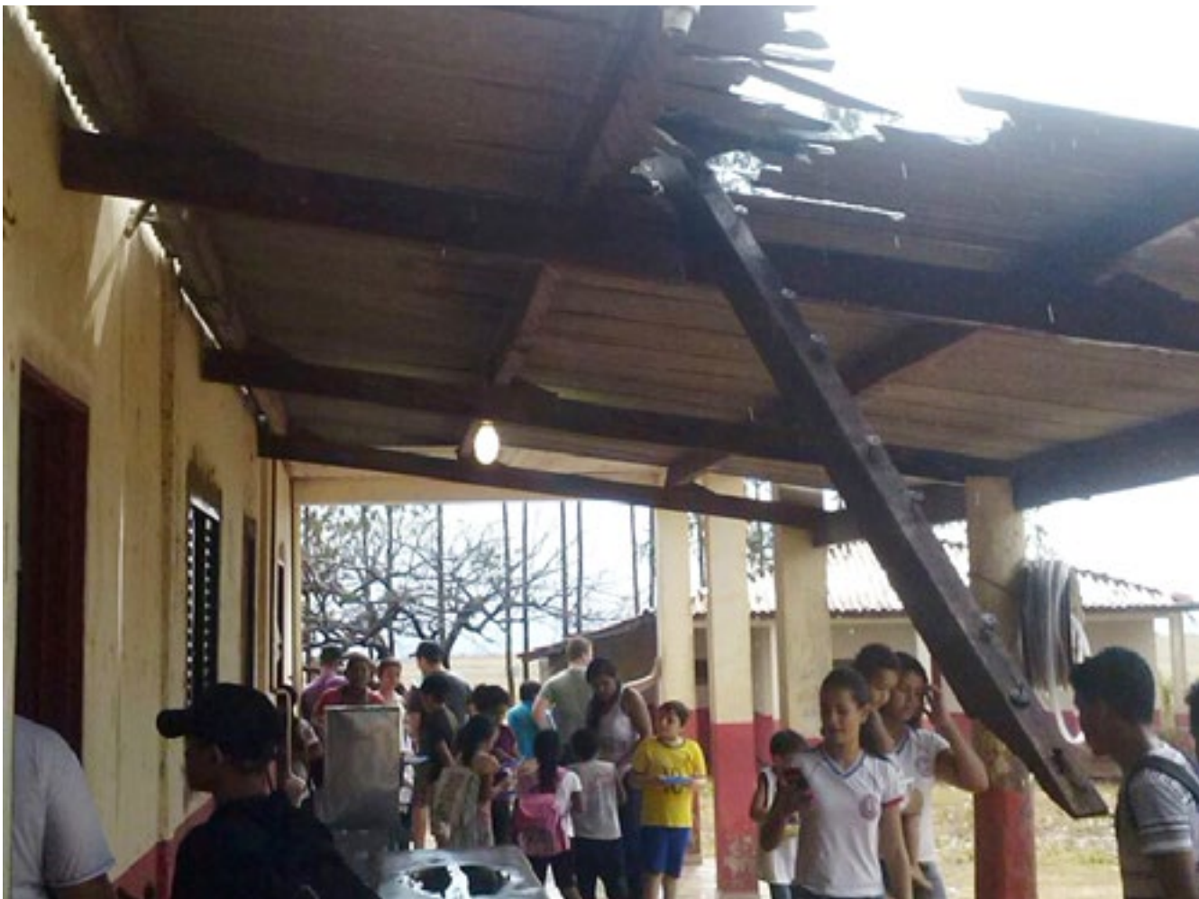
Vento e chuva de granizo causaram destruição na instituição de ensino
