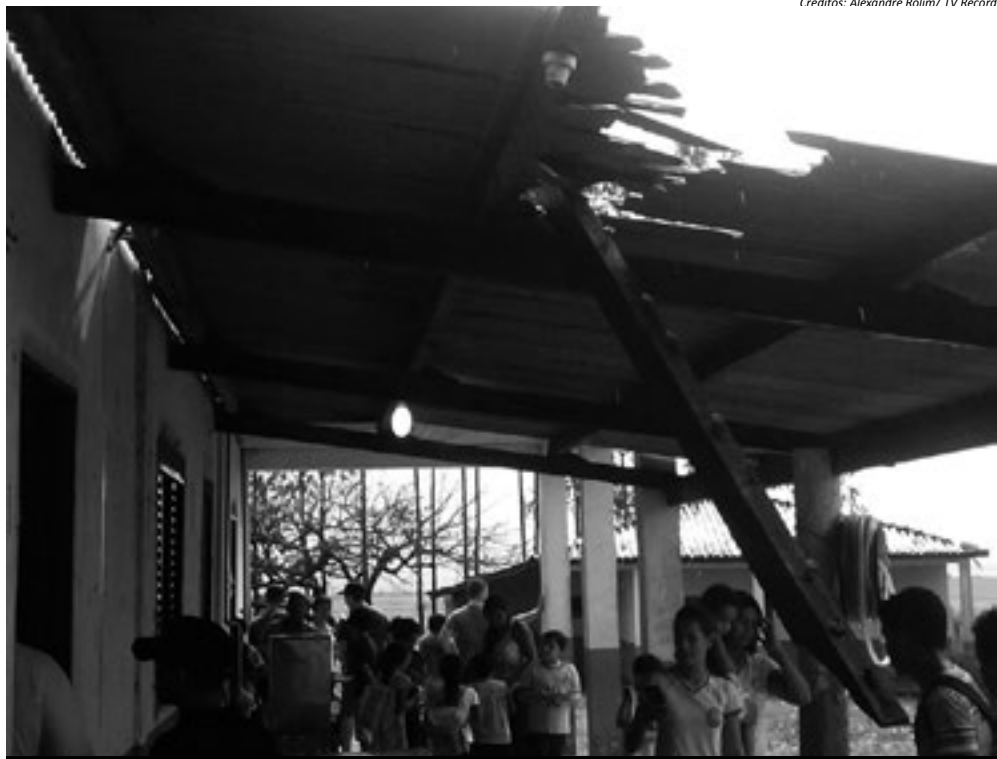
Vento e chuva de granizo causaram destruição na instituição de ensino
