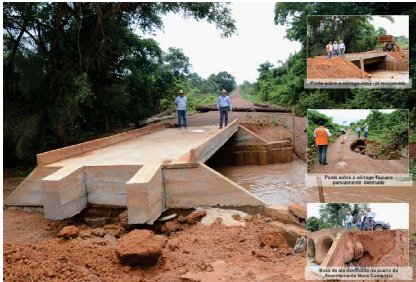
A ponte de concreto sobre o córrego Jacú não sofreu danos e apenas as cabeceiras foram danificadas
