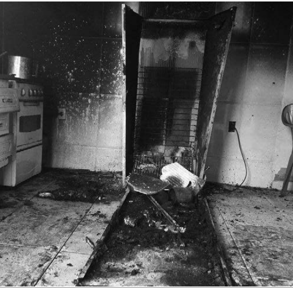
Residência ficou totalmente destruída pelas chamas
