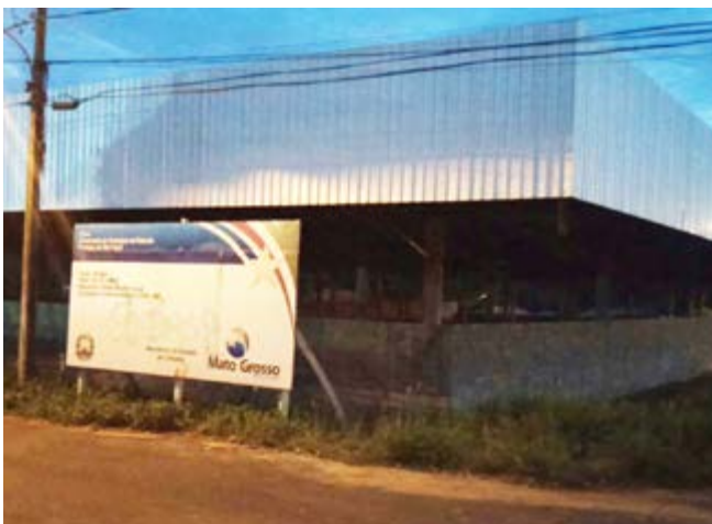
Obra se encontra inacabada, e depende do Estado para continuação
