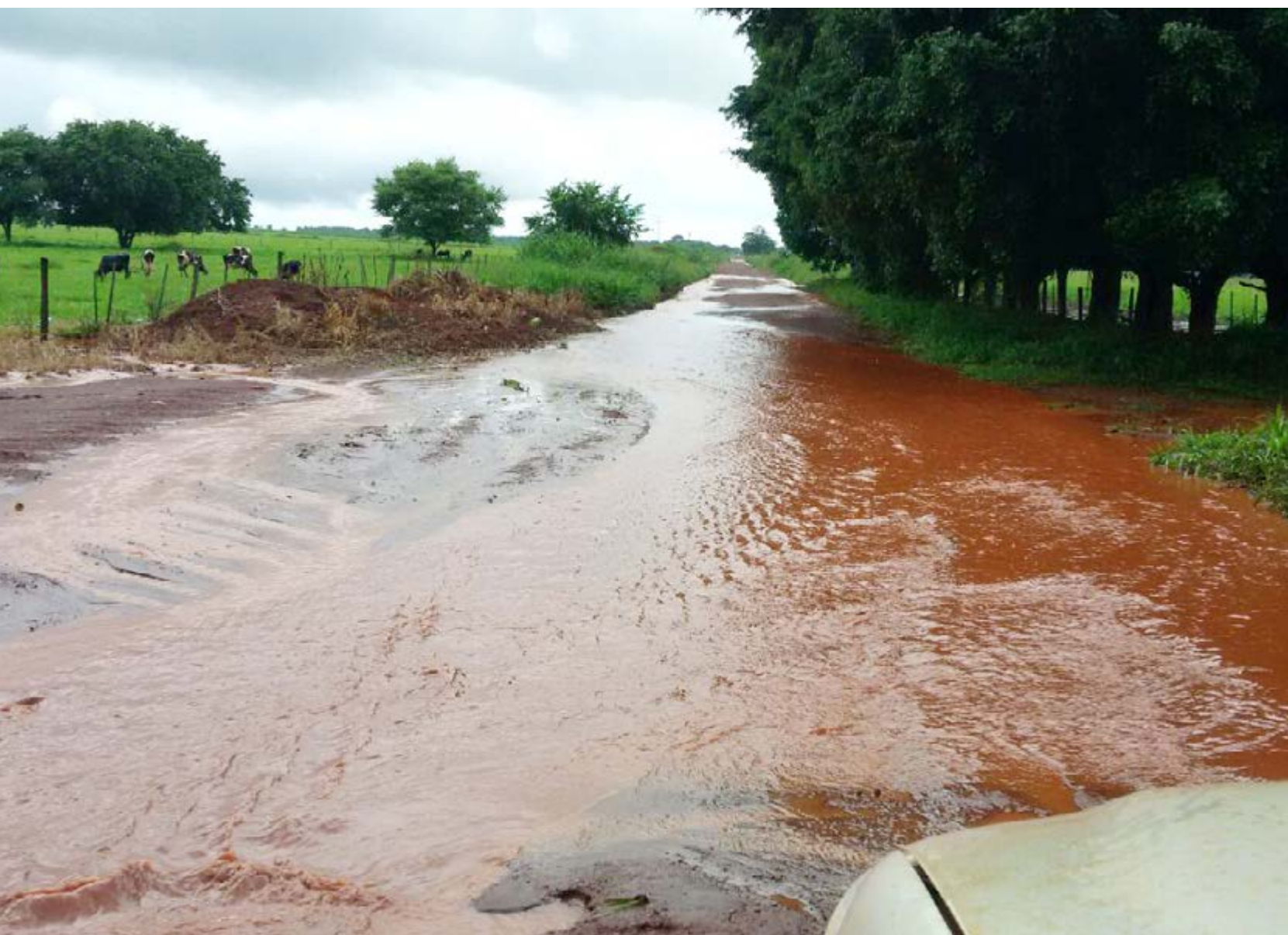
A estrada que liga a Comunidade São Joaquim do Boche à Água Branca está em estado precário, principalmente em dias de chuva
