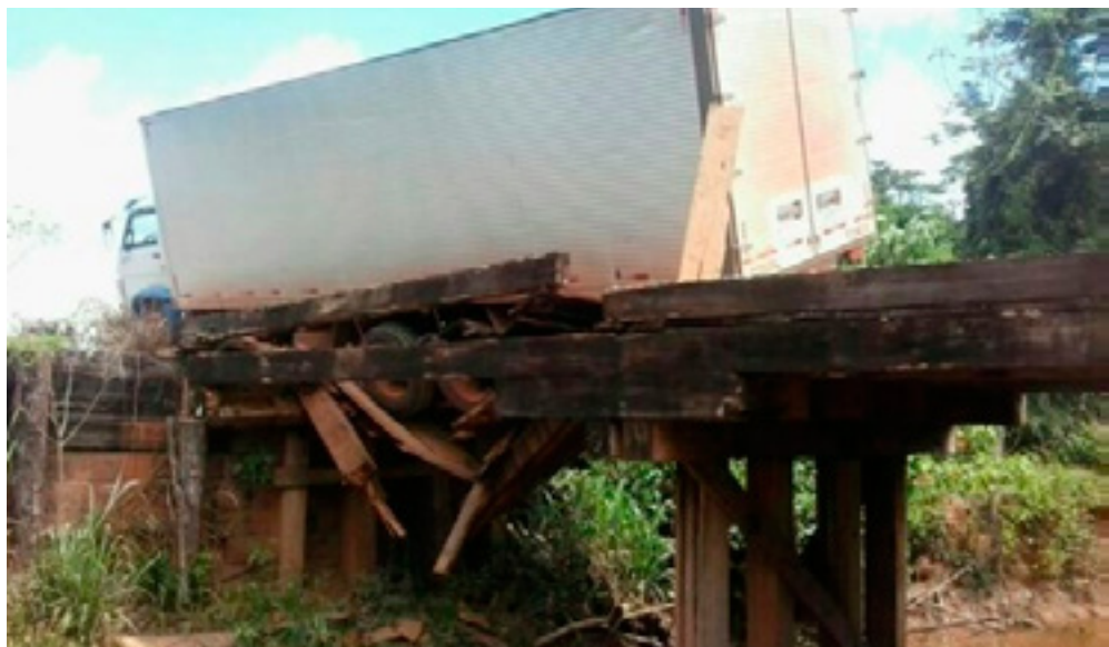
Ponte danificada havia sido reformada em 2012
