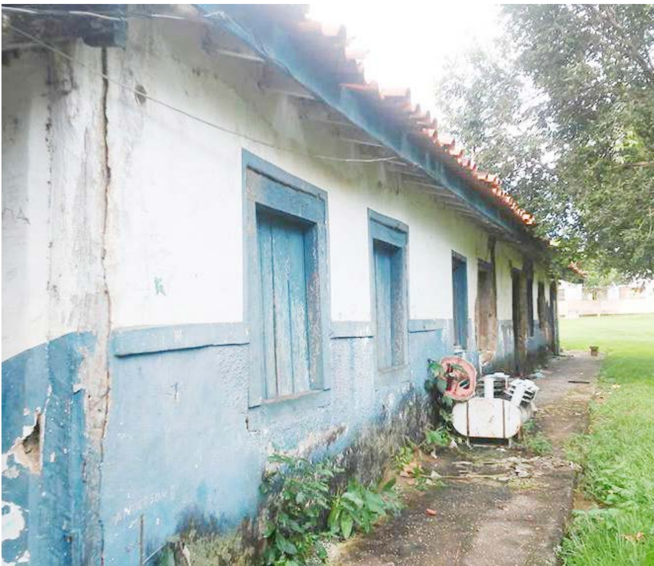
Casa de Rondon que foi tombada como Patrimônio Histórico do Estado está em situação precária
