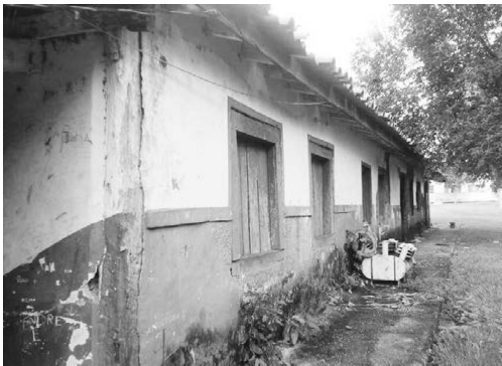
Casa de Rondon que foi tombada como Patrimônio Histórico do Estado está em situação precária
