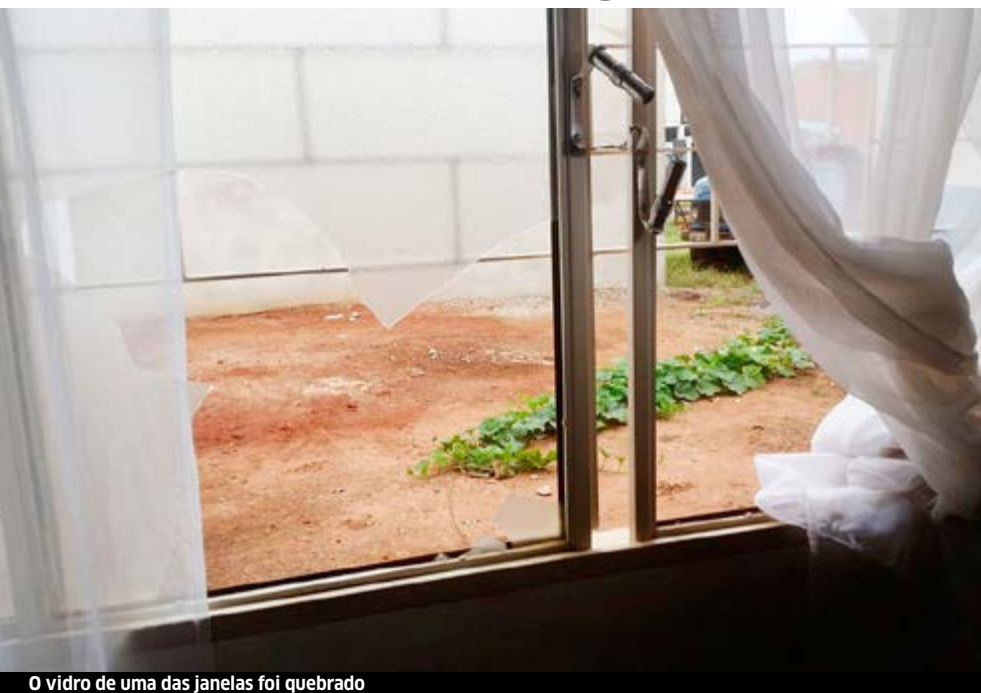
O vidro de uma das janelas foi quebrado
