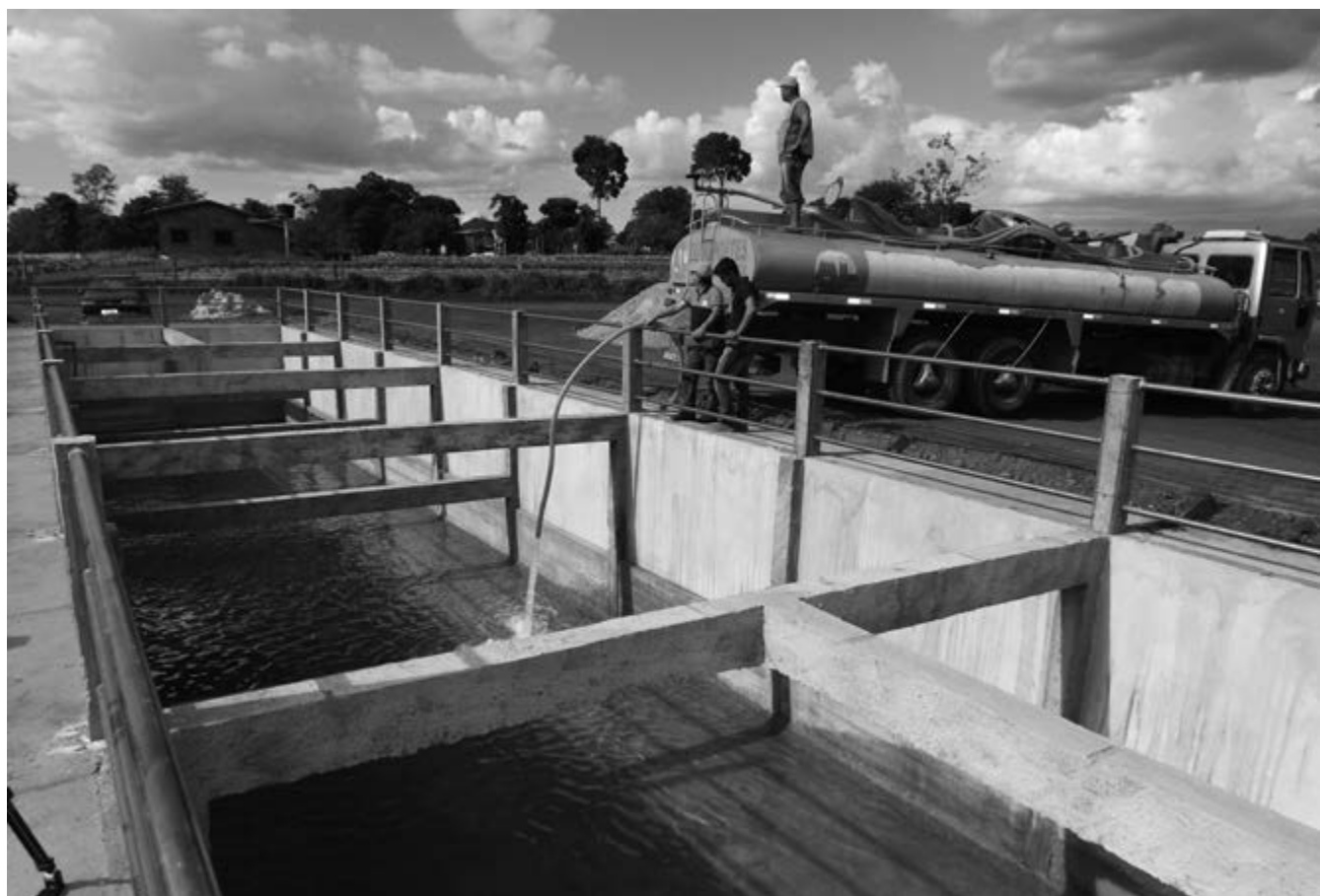
A água está sendo depositada em reservatório da ETA e passará pelo filtro e clorador antes de ser enviada à população
