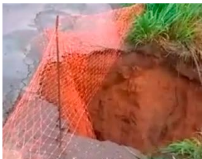
Buraco de profundidade considerável exige cuidado de motoristas
