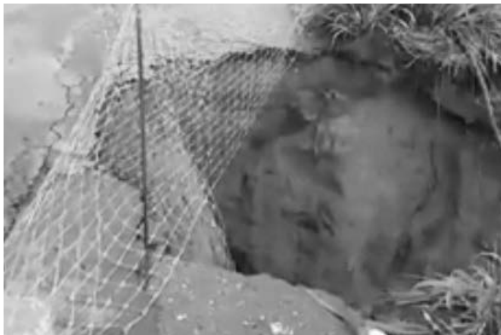
Buraco de profundidade considerável exige cuidado de motoristas
