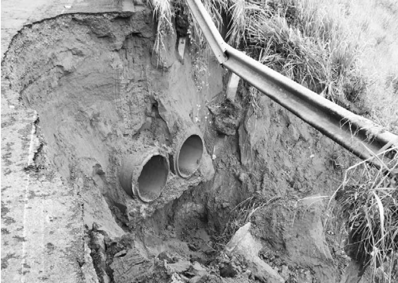
Rompimento no bueiro causou o desmoronamento no acostamento
