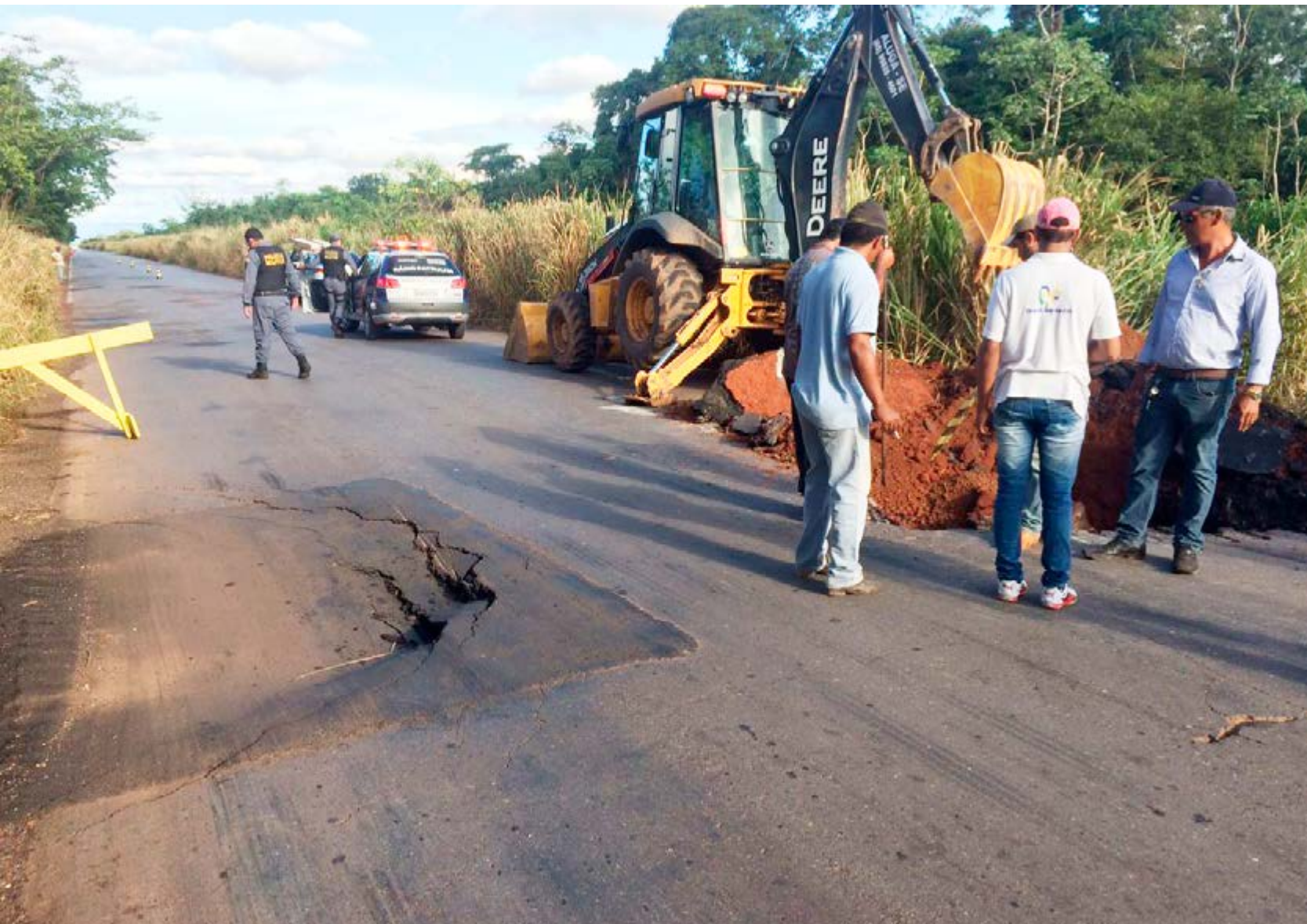
A chuva constante causou o rompimento de um trecho da MT-246, localizado a quatro quilômetros de Barra do Bugres
