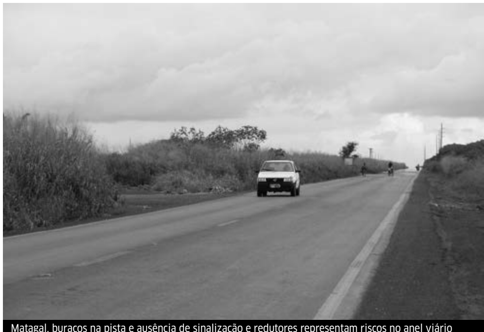
Matagal, buracos na pista e ausência de sinalização e redutores representam riscos no anel viário
