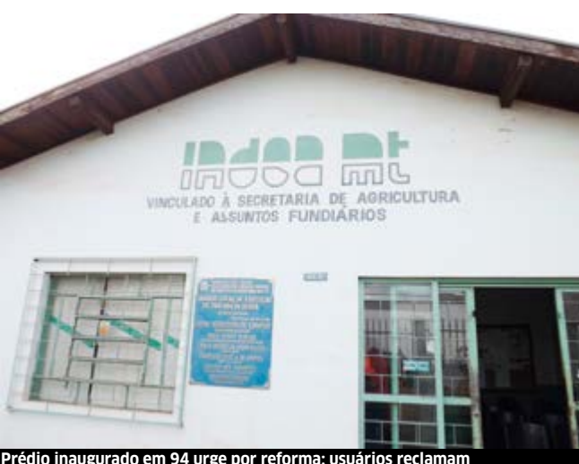
Prédio inaugurado em 94 urge por reforma; usuários reclamam
