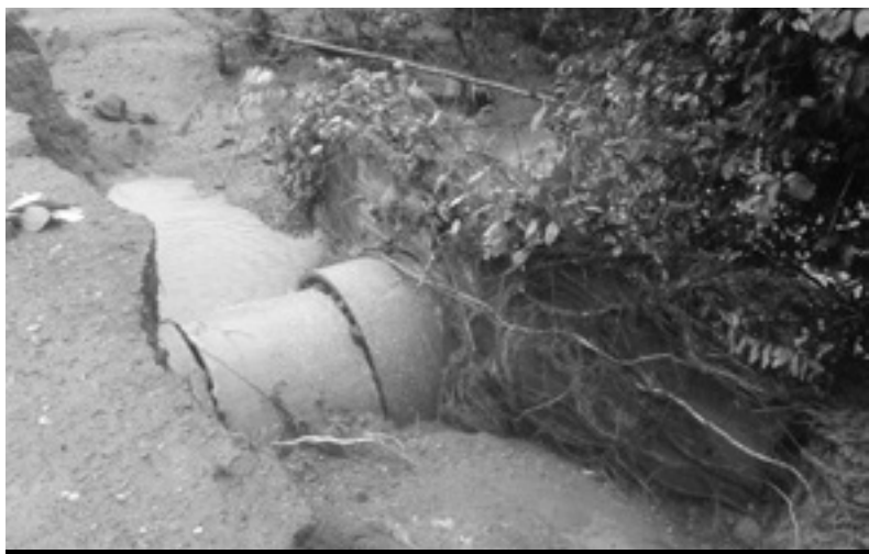
Pontes, bueiros, estradas e ruas da cidade estão comprometidas
