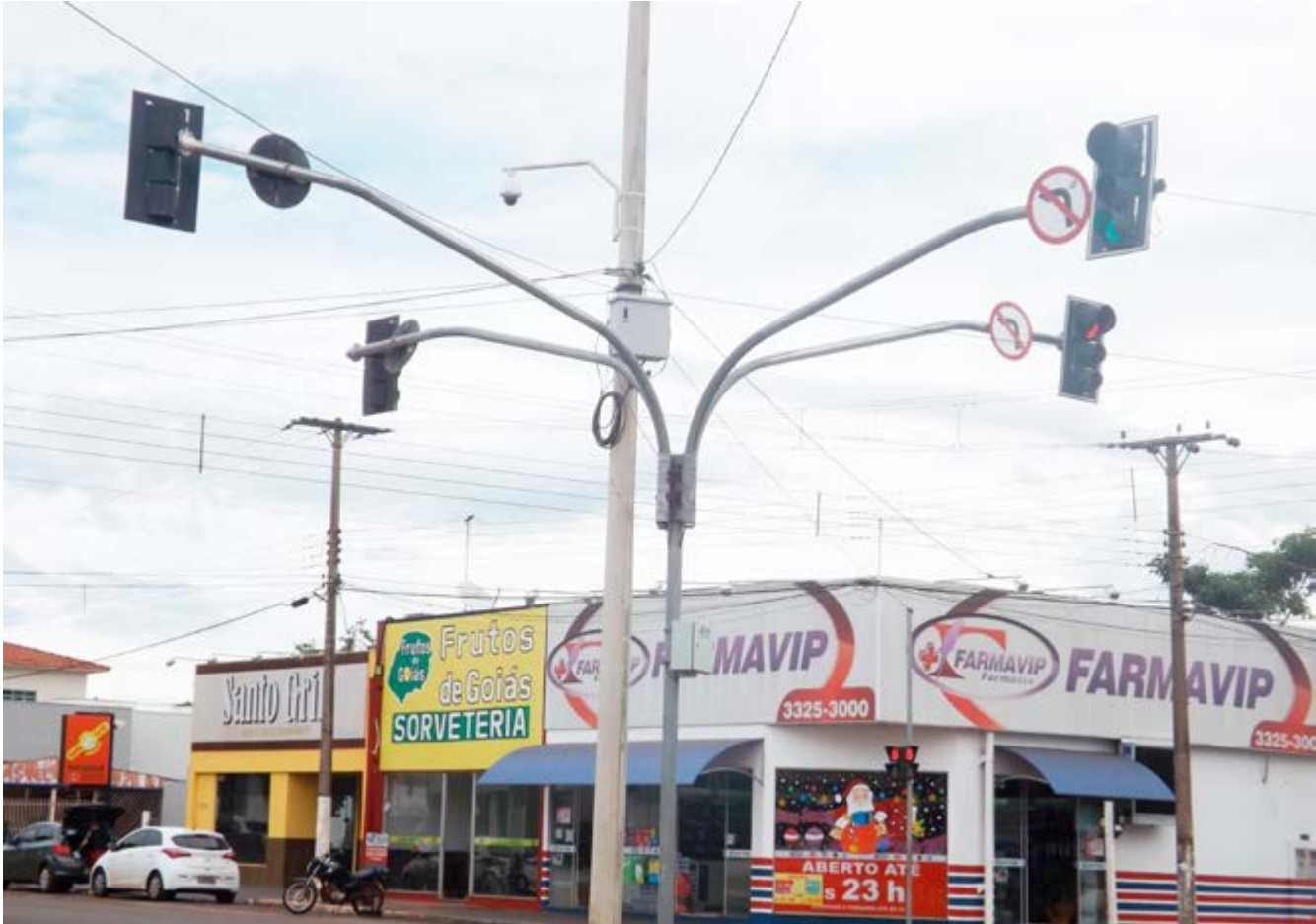
De quinze câmeras instaladas, doze não estão funcionando
