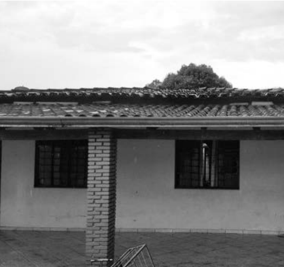
Danos causados por incêndio foram registrados nos fundos do imóvel
