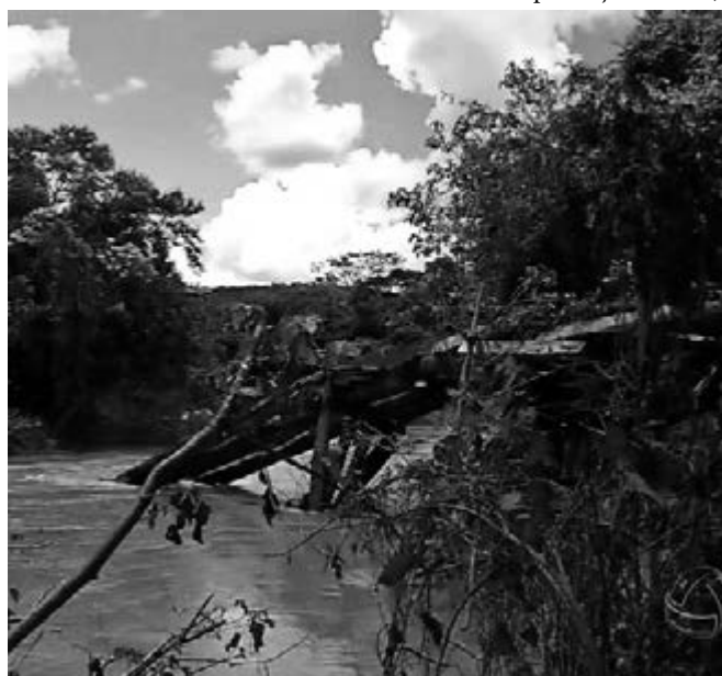
Sendo assim, a ponte ainda não foi reconstruída
