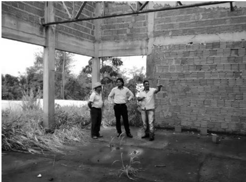
As obras foram paralisadas em 2012 por falta de repasses do Governo Federal
